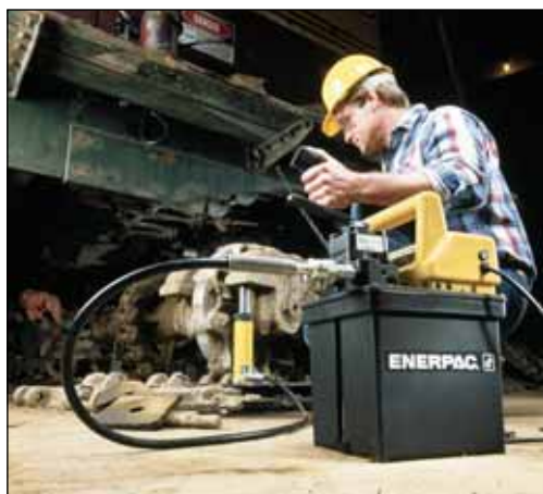
◀ Kauko-ohjauskaapelilla varustettu pumppu helpottamassa nosturin huoltoa.
